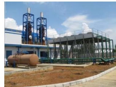
Multidaya Prima Elektrindo Sako, S. Sumatra
